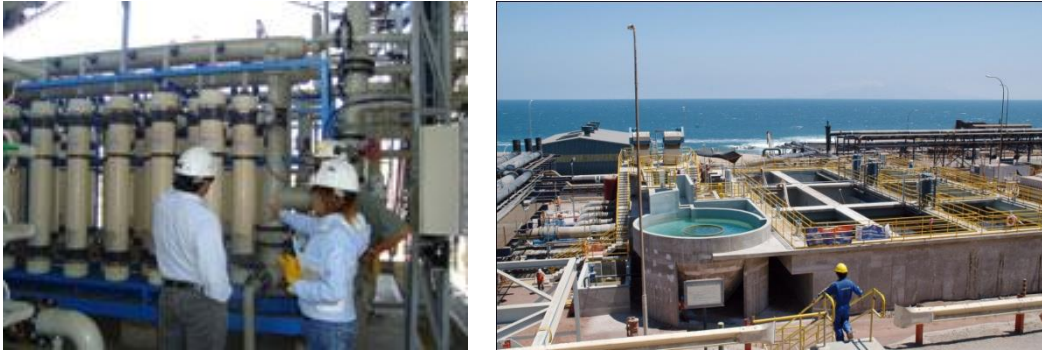
Figura 1: Planta de nanofiltración minera Collahuasi
