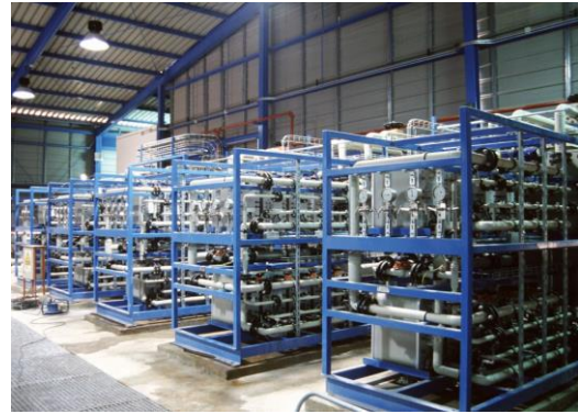
Figura 2: Equipos modulares de electrodesionización en continuo para producción de agua desionizada para calderas de alta presión (producción 2.850 m 3 /día).
