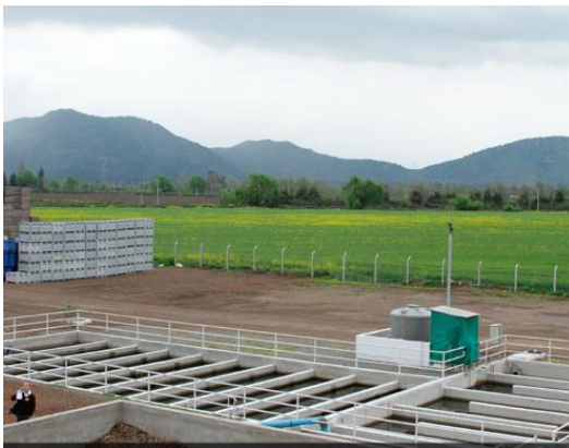
Figura 1: Proyecto biofiltros en empresa Agrofoods situada en Malloa (Chile), con un caudal de tratamiento de 2.200m 3 /d.
