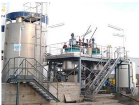
Figura 1: Tratamiento de Efluentes Industriales por Oxidación Avanzada, TRISA, Constantí (Tarragona)
