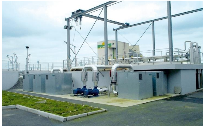
Figura 1: Planta tratamiento BRM efluentes matadero, Bretaña (Francia).
