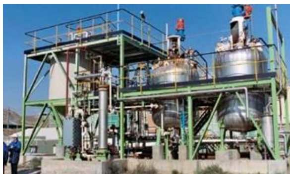
Figura 2: Planta Oxidación en funcionamiento, FMC Foret Sant Cugat del Vallés (Barcelona).
