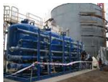
Figura 2: Planta de osmosis reversa Orafti S.A. (Chile).
