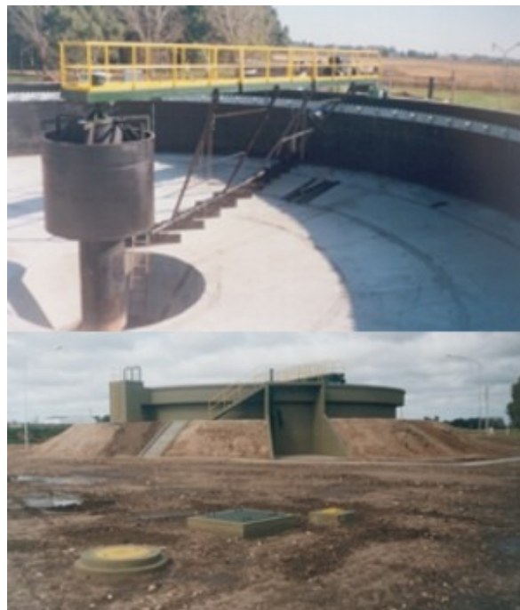
Figura: sedimentador típico de una planta de tratamiento de aguas servidas
