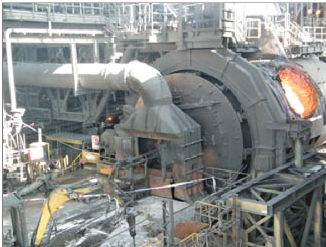
Figura 5.4.1.b Sistema de captación de gases fugitivos desde sangría
