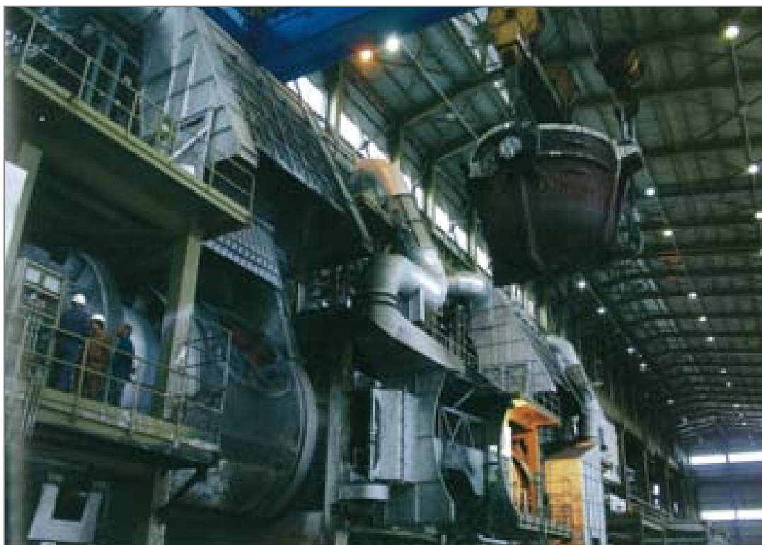
Figura 5.4.2.a Sistema de campana secundaria y captura de gases fugitivos de olla
