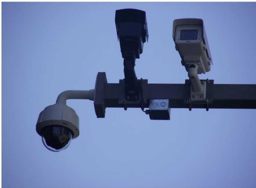
Foto N°3: Cámaras Proyecto Alameda para el Control de Vías Exclusivas
