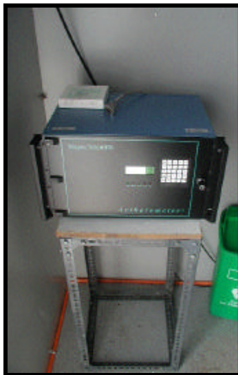
Figura 2. Instalación interior de Equipo Carbono elemental (Cele) MP 2.5 Marca Magee. Estación Peñaflores.
