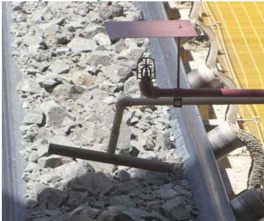
Figura 5-24. Descarga Chancador 1º a Correa (Aspersores)
