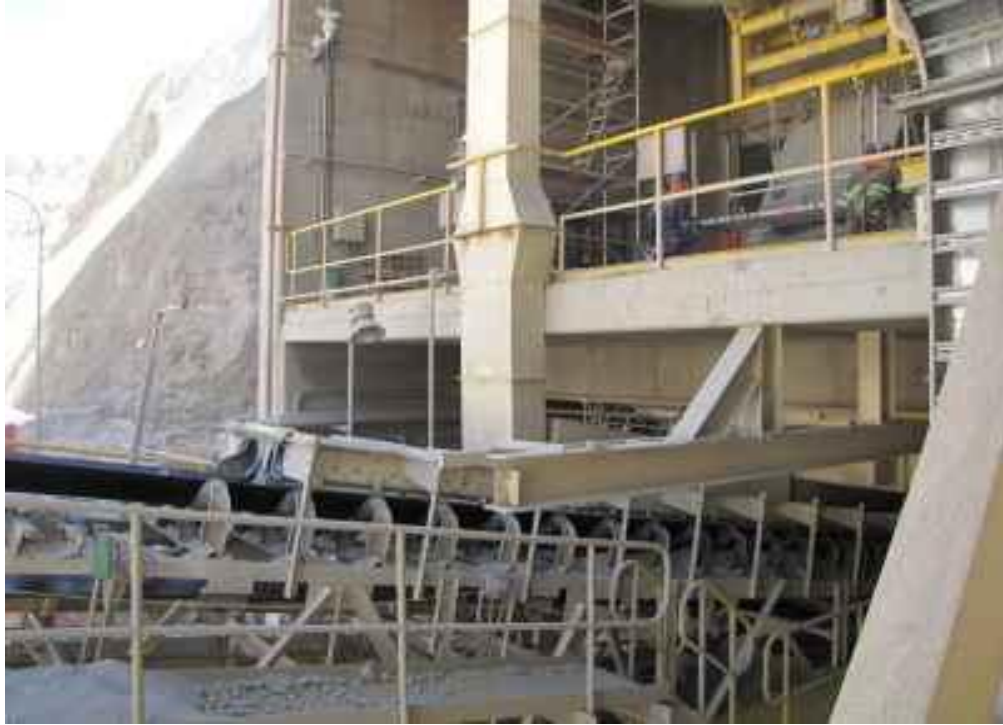
Figura 5-23. Descarga Chancador 1º a correa transportadora
