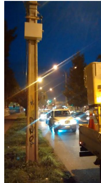
Estación Calle Caupolicán Av. Caupolicán #489, entre Portales y Rodríguez Tipo Vía Servicio con Loc. Col.
