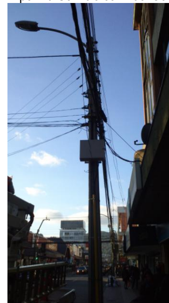
Estación Calle Manuel Bulnes Calle Manuel Bulnes #539 Tipo de Vía Servicio sin Loc. Col.
